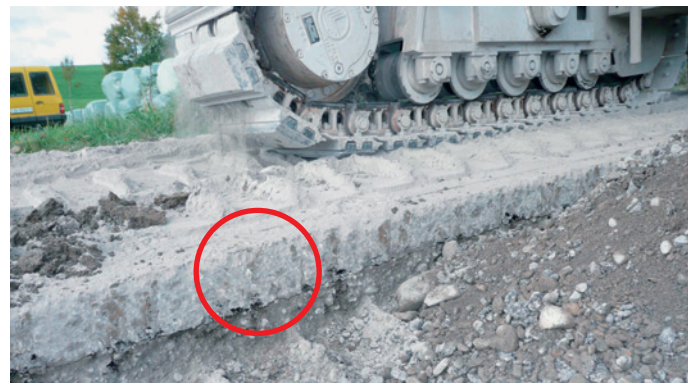
8. Fräsen von oben nach unten: Dank dem Downcutting werden Alt-Asphaltschichten bis 20 cm in den Untergrund «geraffelt».
