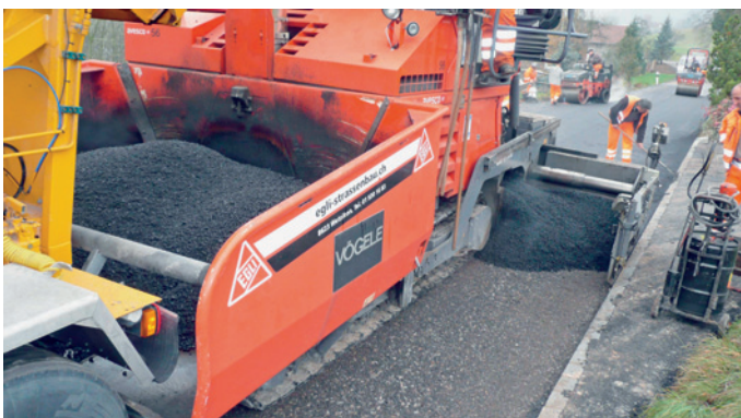
17. Einbau einer Trag- /Deckschicht: Die mit Fertiger aufgebraachte SAMI garantiert eine grosse Ebenheit. Darüber erfolgt ein traditioneller Heissbelageeinbau.
