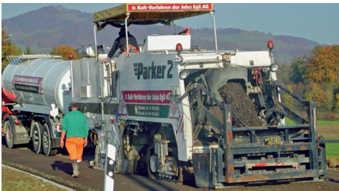
7. Komplexrecycling: Bei der Zugabe von Zement und Bitumenemulsion wird der Emulsionstanker vorgeschoben.
