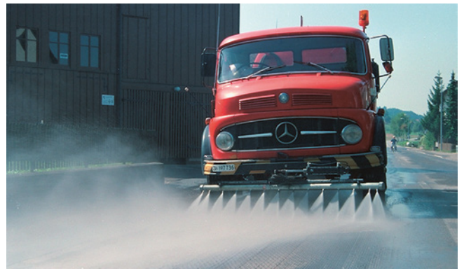
6. Waschen: Die Strasse ist vor dem Verlegen des Kaltmikrobelages mit einer Hochdruckmaschine zu waschen damit der Belag optimal mit dem Untergrund verkleben kann.
