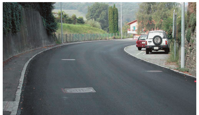
12. Fertige Strasse: Der eingebaute Belag muss nicht gewalzt werden und ist schon kurz nach dem Einbau befahrbar.
